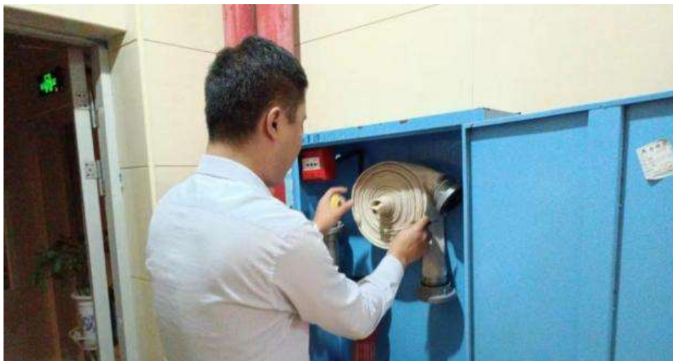
消防水管測試
